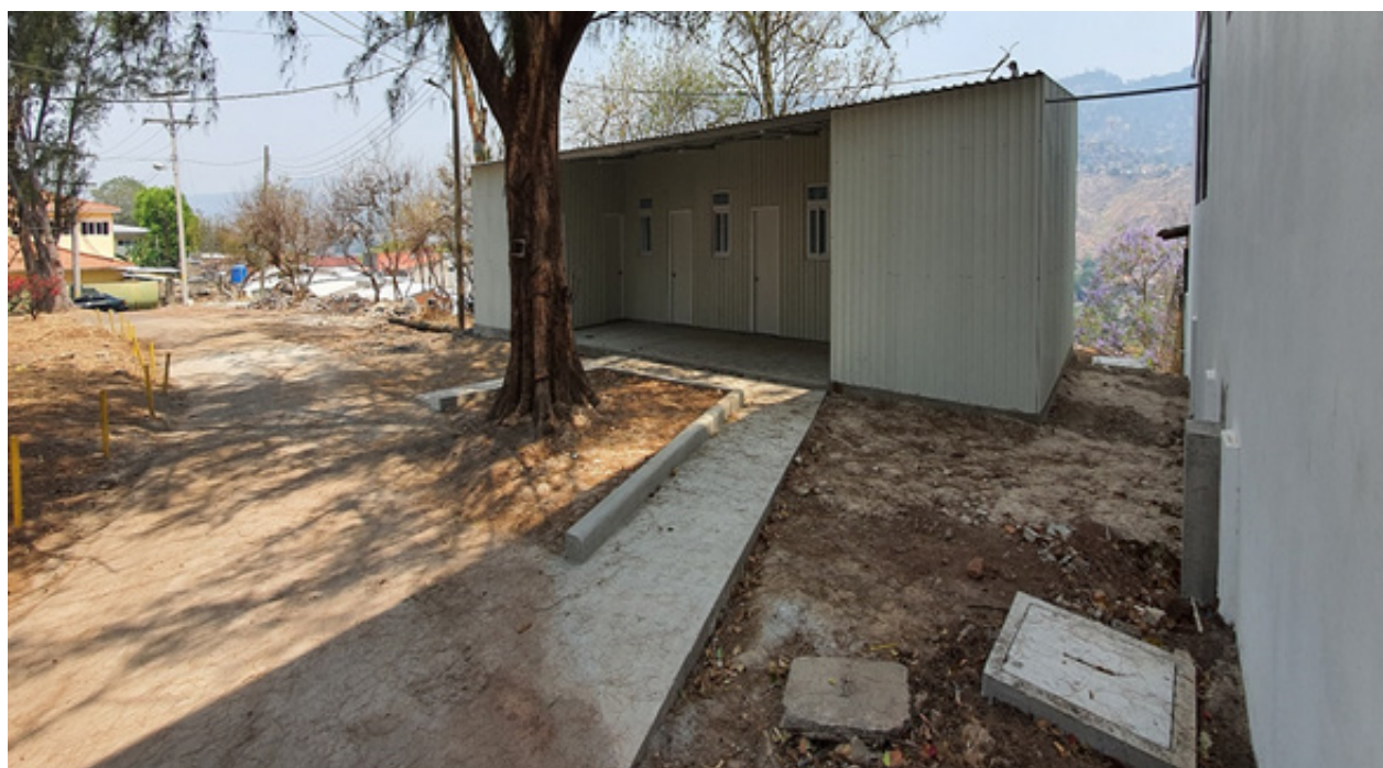
Fotografía tomada a la sala de triaje construida contiguo al edificio JICA.
