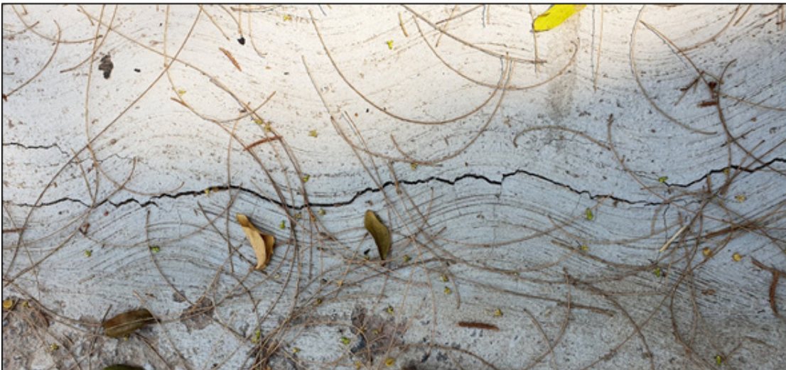
En las fotografías se observa las grietas que se han formado en una obra relativamente reciente.
