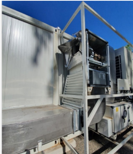
Descripción: daños de ductos sistema de climatización HRF+AHU.
