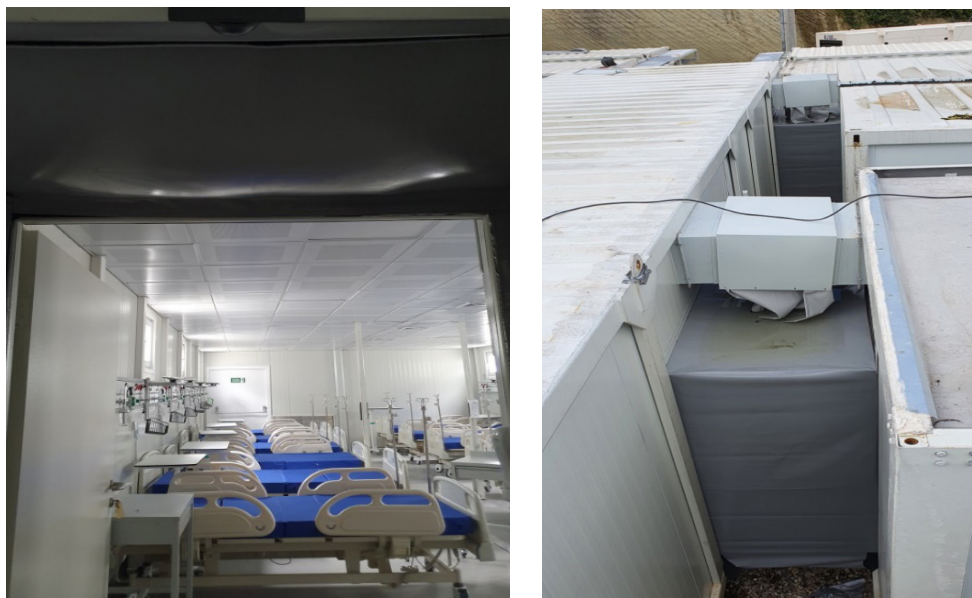
Descripción: depósito de agua estancada en acopladores de contenedor.
