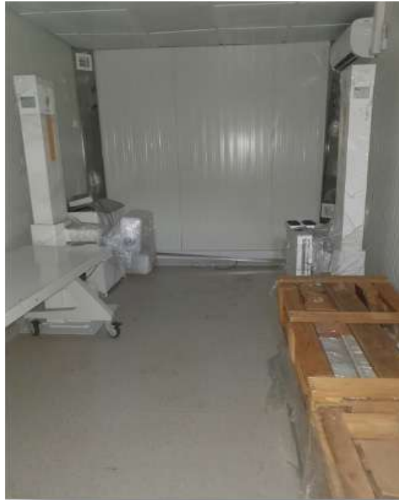
Descripción: área de radiología del hospital modular de La Ceiba.
