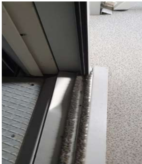
Descripción: daños en el marco de la puerta corrediza.
