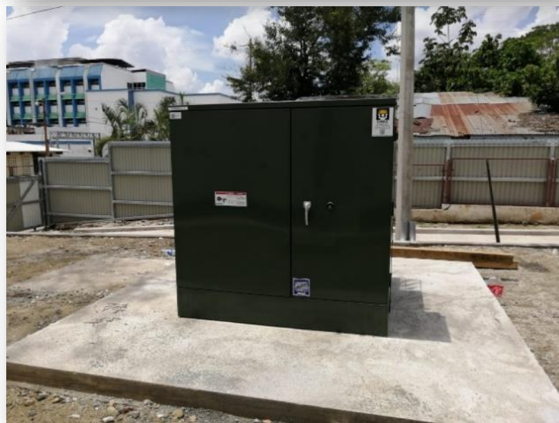
Listado de evidencias n.º 15. Tanques de almacenamiento de agua y transformador eléctrico.
