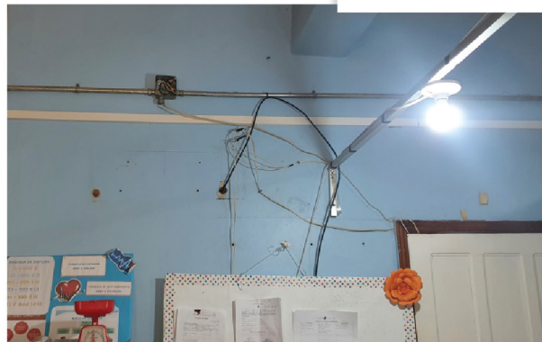
Malas instalaciones eléctricas y falta de iluminación artificial en algunas áreas.
