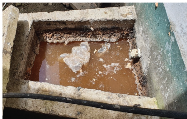
Problemas severos en mezcla de agua potable con heces fecales.
