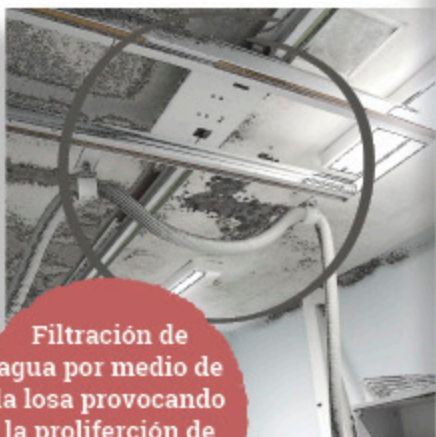
Deterioro en cielos falsos por humedad.
