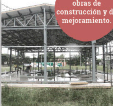
Obras inconclusas y abandonadas.
